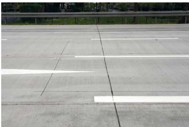
Bild 16: Induktionsschleife in Betonfahrbahn
