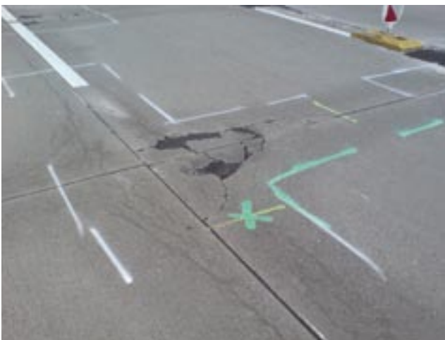
Bild 6: rissgeschädigte Fugenbereiche, teilweise mit Verschotterung
