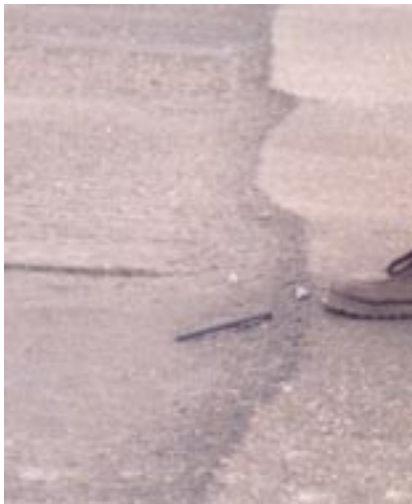
Bild 2: Gefräste Asphaltstraße mit Spurrinnen
