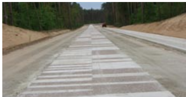
Ergebnis Beton mit Abplatzungen gemäß Pkt. 3
