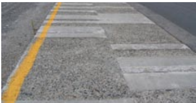
Anforderung Beton mit Abplatzungen gemäß Pkt. 3
