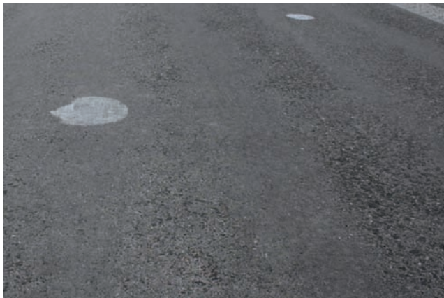
Abb. 9: Betonoberfläche mit heterogen ausgebildeten Abwitterungen
