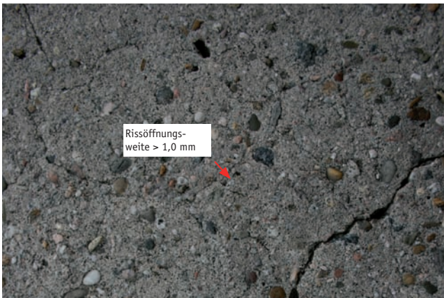
Abb. 4: Krakeleerisse mit einer Rissöffnungsweite von 0,10 mm bis >1,0 mm
