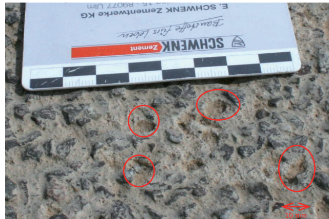
Abb. 5: Kornausbrüche auf einer Waschbetonoberfläche
