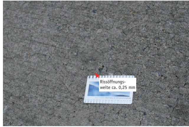
Abb. 3: Krakeleerisse mit einer Rissöffnungsweite von 0,10 mm bis 0,25 mm
