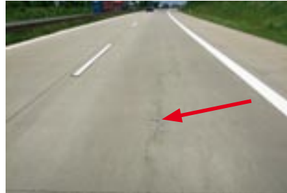
Bild 6: Übersichtsaufnahme Applikationsbereich Lithium mit mittigem Längsriss in der Lastspur (06/2010)
