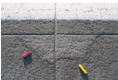
Bild 11: Anzeichen von Schrägrissen im Fugenkreuz zwischen Last-/ Standspur in der DSK (02/2011)
