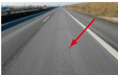
Bild 10: Übersichtsaufnahme Überbauungsbereich DSK 5 mit durchgeschlagenem mittigem Längsriss (02/2011)
