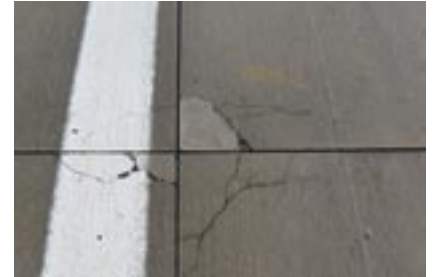
Bild 7: stark geschädigtes Fugenkreuz zwischen Last-/ Standspur im Applikationsbereich Lithium (02/2011)
