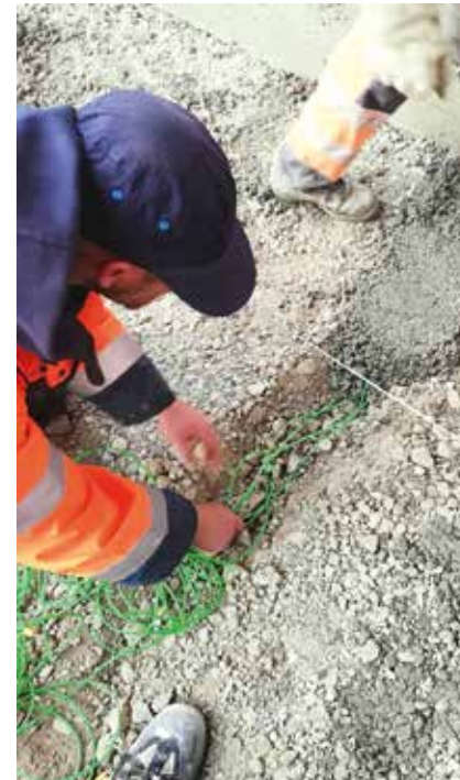
Bild 14: Verlegung der Messkabel innerhalb der STSuB zum Messcomputer
