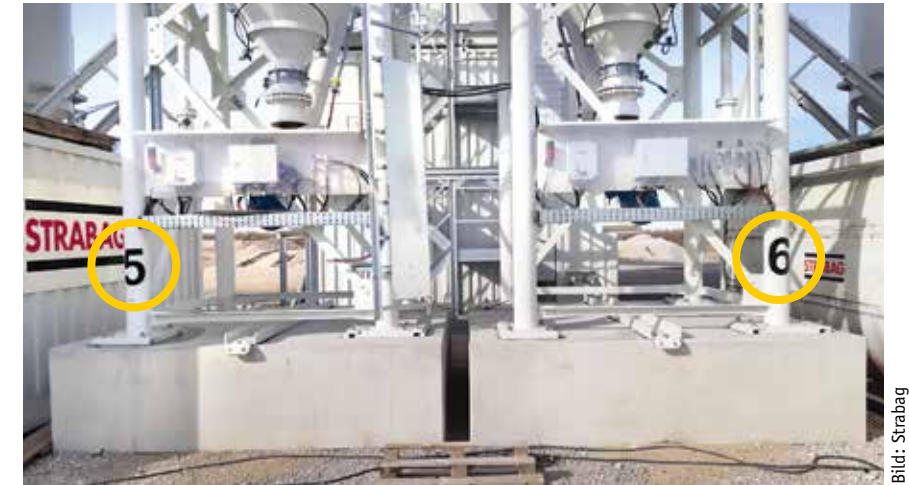
Bild 19: Deutliche Kennzeichnung der Zementsilos
