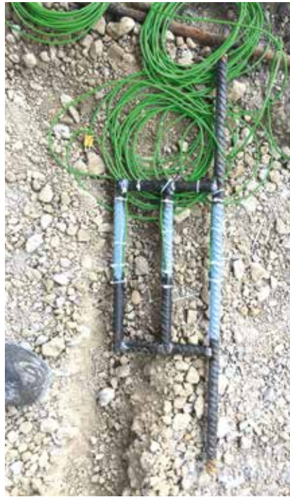
Bild 13: Hilfskonstruktion für die drei Sensoren im Unterbeton
