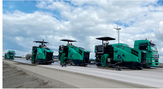
Bild 4 Parallelfahrt von drei Grindingmaschinen
